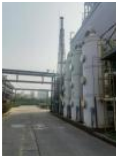
废气处理设施
