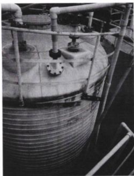
特殊高浓度废水收集罐
